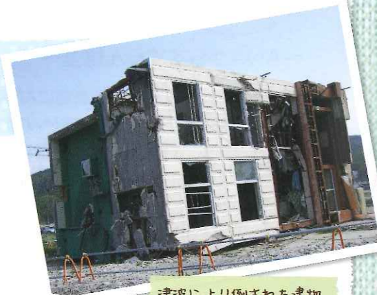
津波により倒された建物
